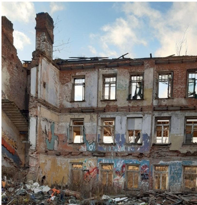
Опасные для жизни и здоровья объекты: заброшенные сооружения (1)
