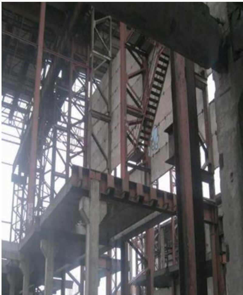
Опасные для жизни и здоровья объекты: заброшенные сооружения (5)
