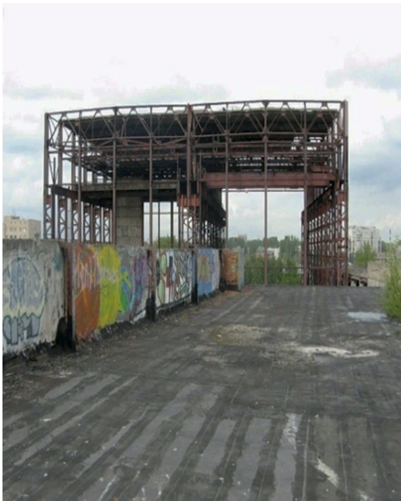
Опасные для жизни и здоровья объекты: заброшенные сооружения (3)
