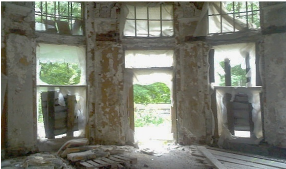
Опасные для жизни и здоровья объекты: заброшенные сооружения (9)
