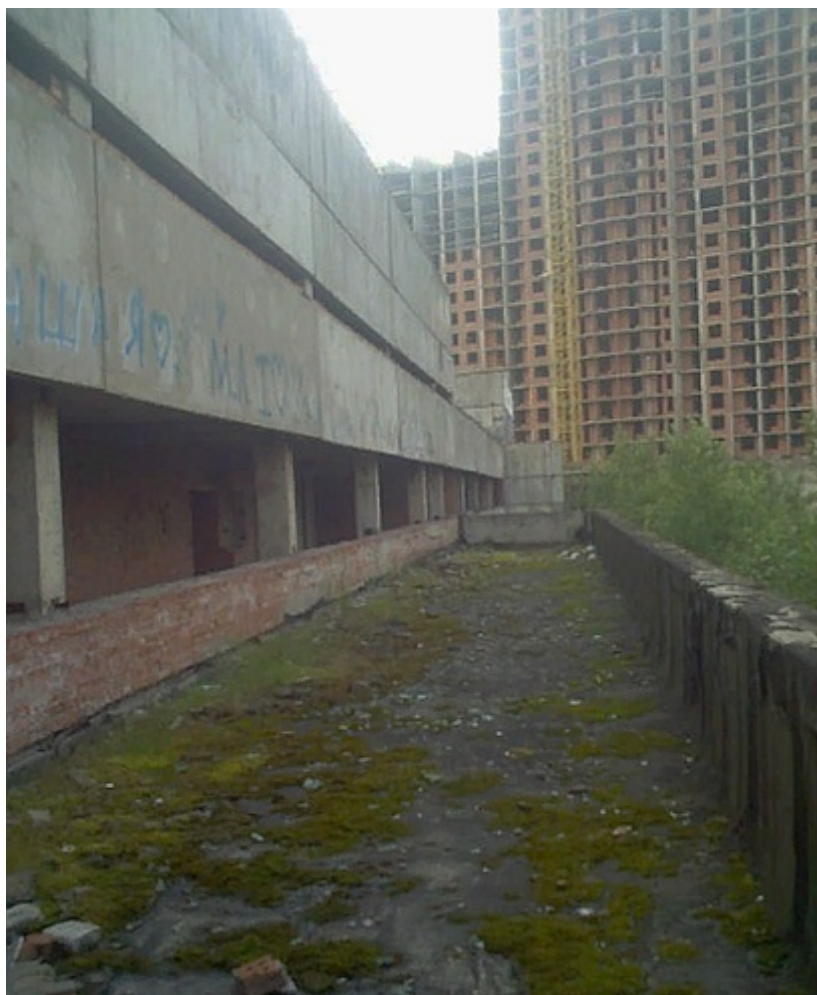
Опасные для жизни и здоровья объекты: заброшенные сооружения (6)
