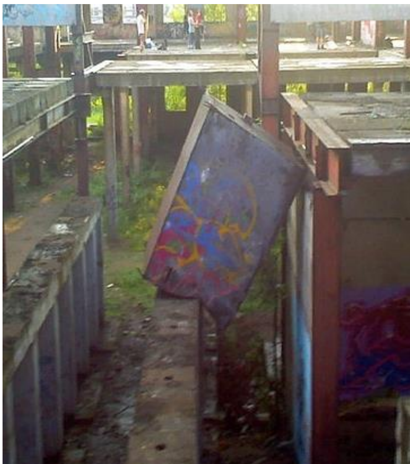
Опасные для жизни и здоровья объекты: заброшенные сооружения (4)
