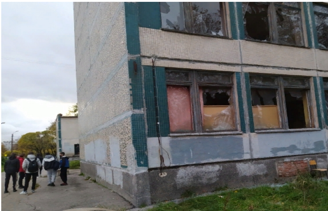
Опасные для жизни и здоровья объекты: заброшенные сооружения (10)
